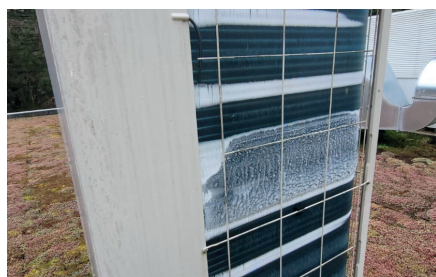
Exemple d'unité extérieure de pompe à chaleur en cours de givrage malgré une température extérieure positive ( +5^{\circ}\text{C} ).
